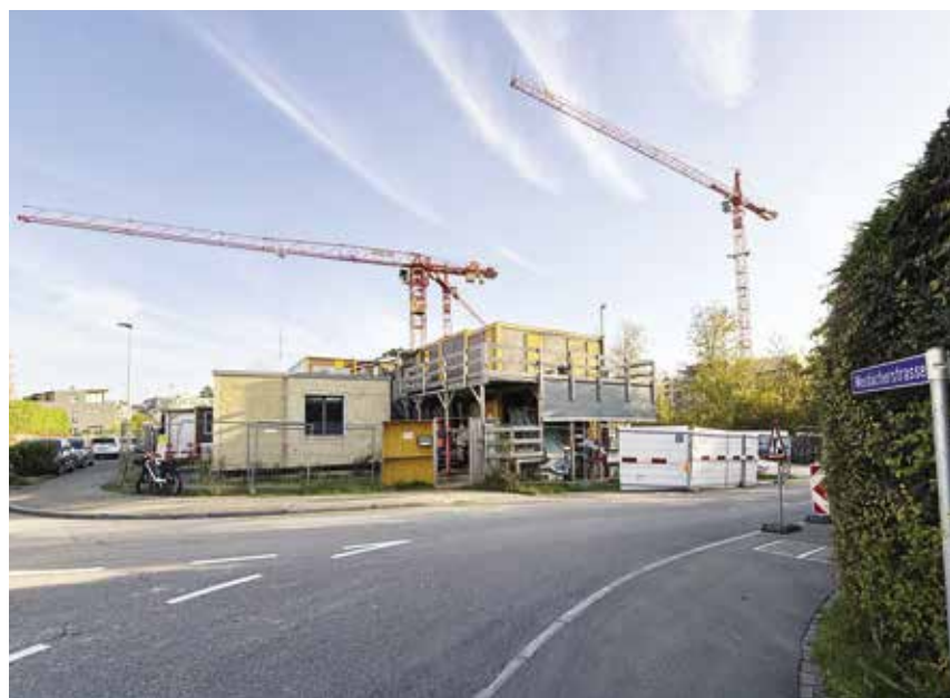
Die Grossbaustelle verbirgt sich hinter den Baucontainern an der Ecke Weidächerstrasse und Lütisämetstrasse.
