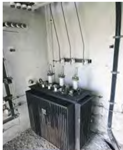
Rorguet: Der Trafo im Innern. Foto: Th. Zimmerli
