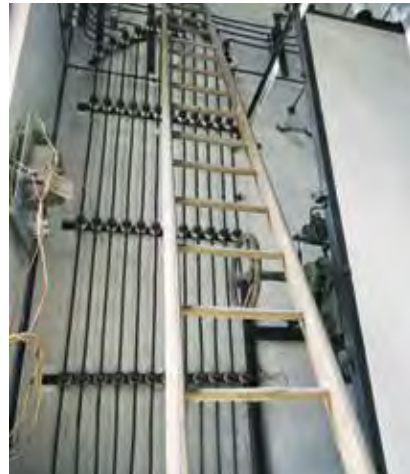
Rorguet: Abenteuerliche Aufstiegsleiter und Inneninstallation. Foto: Th. Zimmerli
