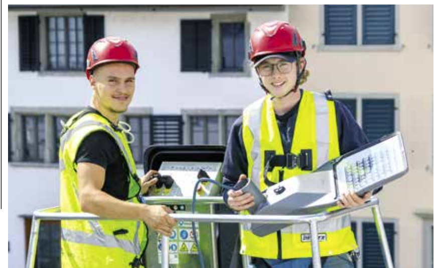
Die erste Etappe der Umrüstung auf LED ist abgeschlossen.
