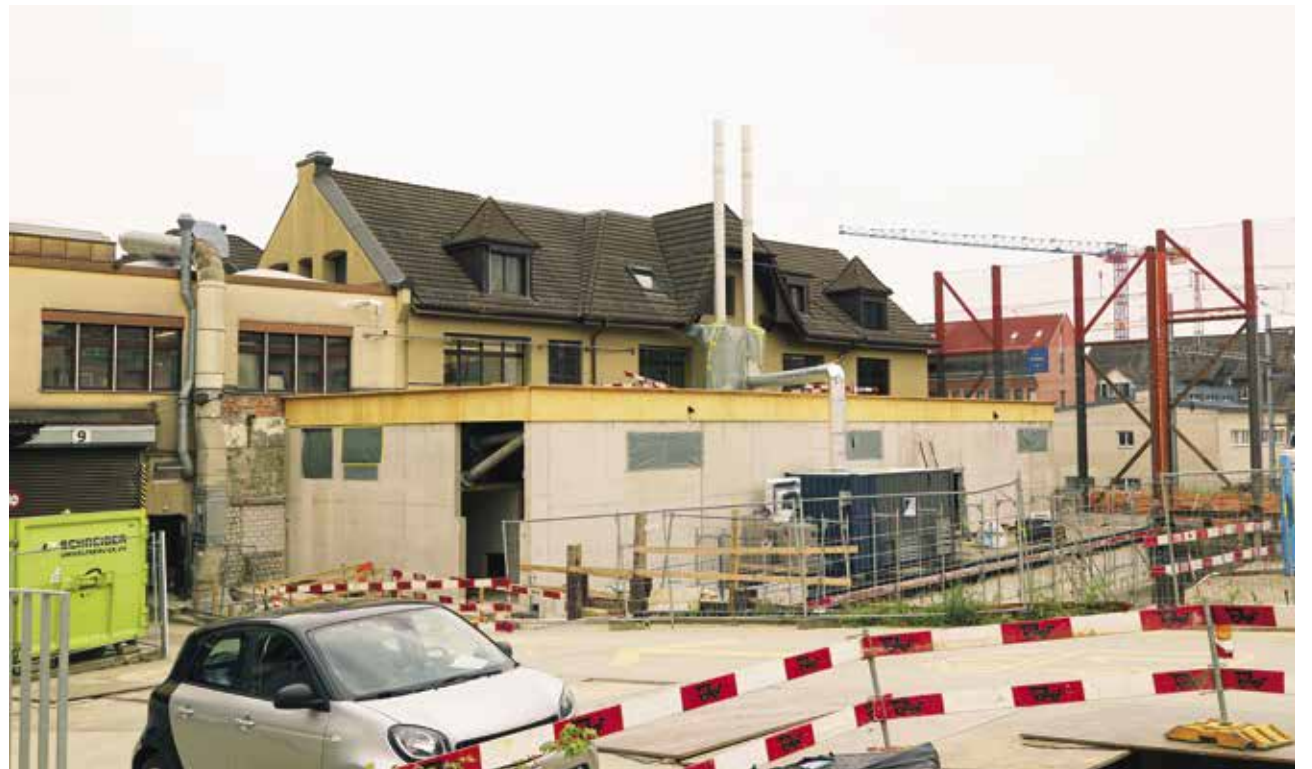
In diesem Gebäude an der Oberen Kirchgasse, bergwärts der Bahngelise, befindet sich die Energiezentrale des Wärmeverbundes.
