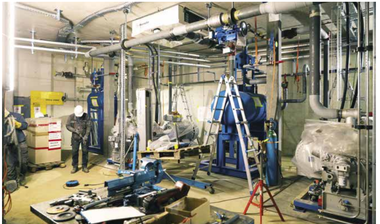
Die technischen Installationen befinden sich im Untergeschoss der Zentrale.
