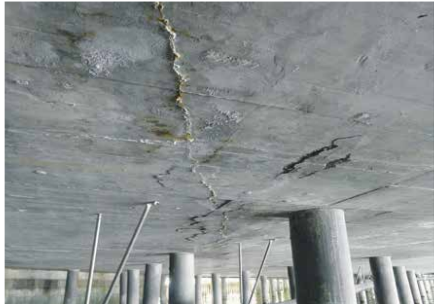
Der Riss auf der Unterseite der Plattform. Foto: zvg
