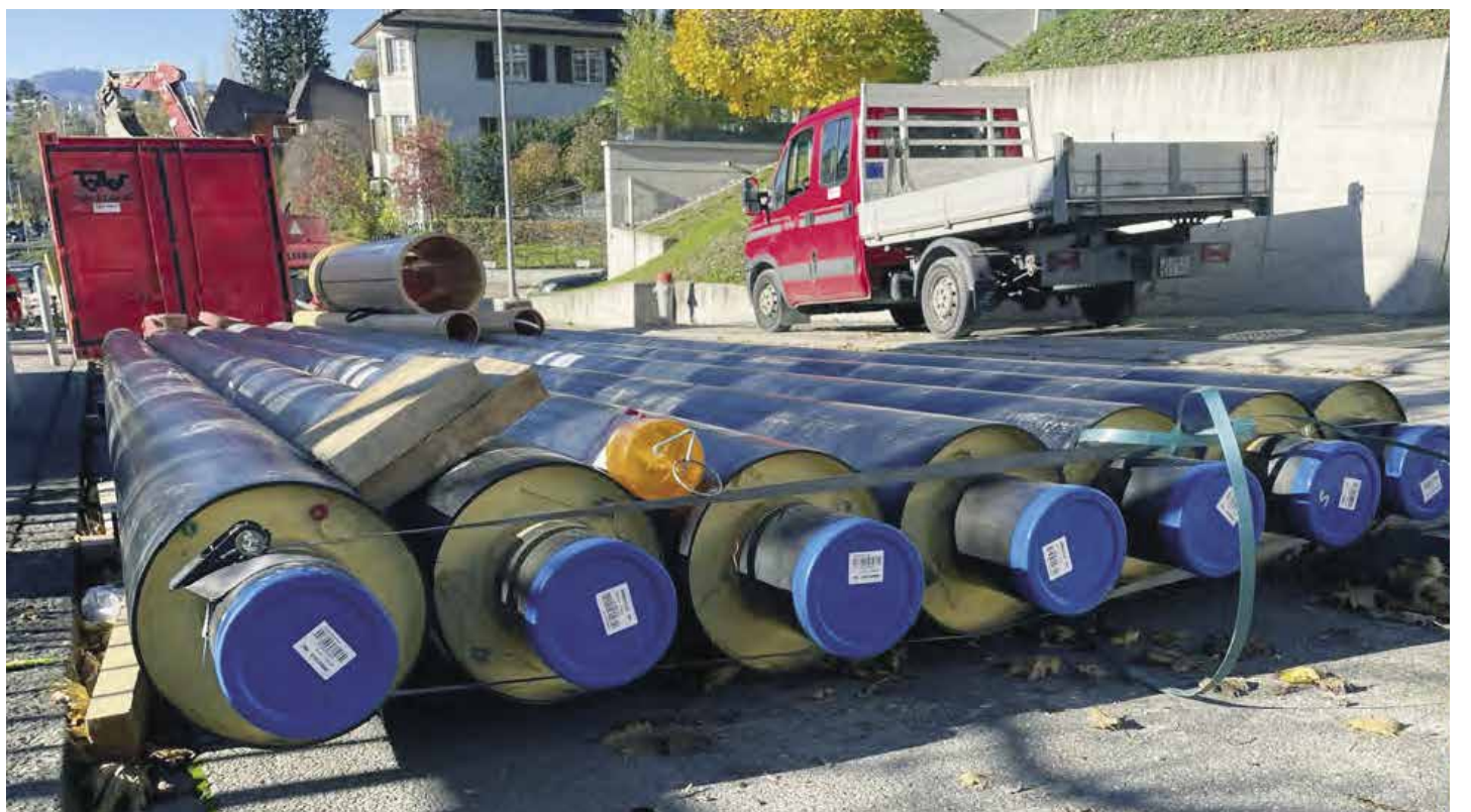
Durch diese Fernwärmerohre wird die Meilemer Bevölkerung mit erneuerbarer Energie versorgt.
