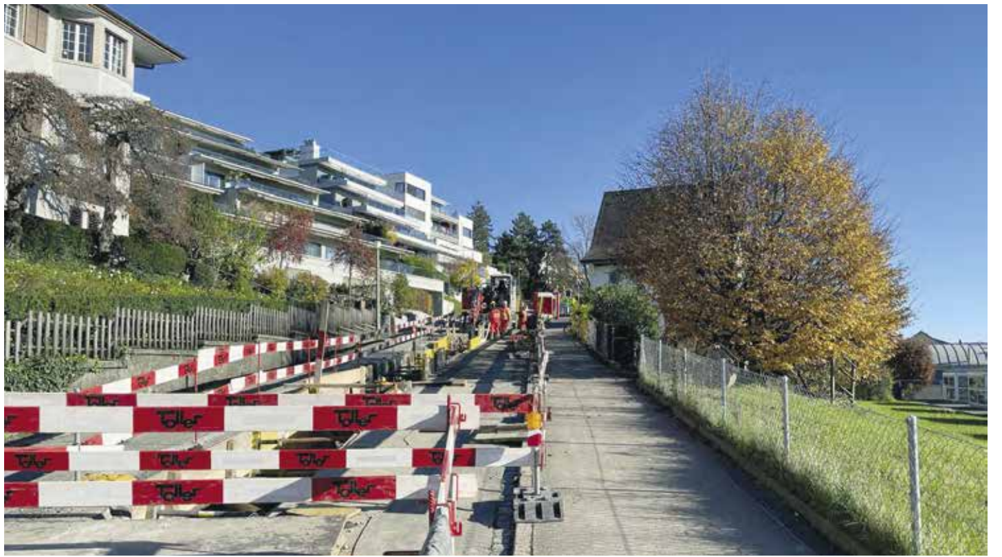
Die Bauarbeiten für den Energieverbund Meilen sind im vollen Gange: Hier werden die Rohre für das Fernwärmenetz in der Burgstrasse verlegt. Fotos: zvg
