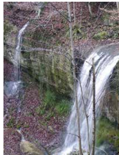
Der aus Undichte des Damms herrührende kleine Wasserfall.
