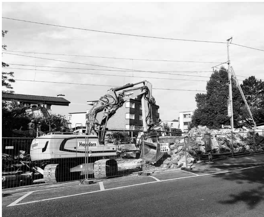
Am Samstagmorgen klaffte da, wo normalerweise eine Brücke ist, ein grosses Loch.
