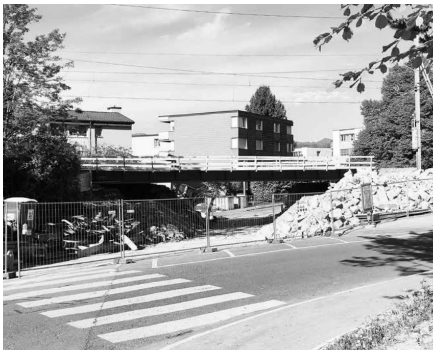
24 Stunden später stand die Hilfsbrücke, über die die Züge im nächsten halben Jahr fahren werden.
