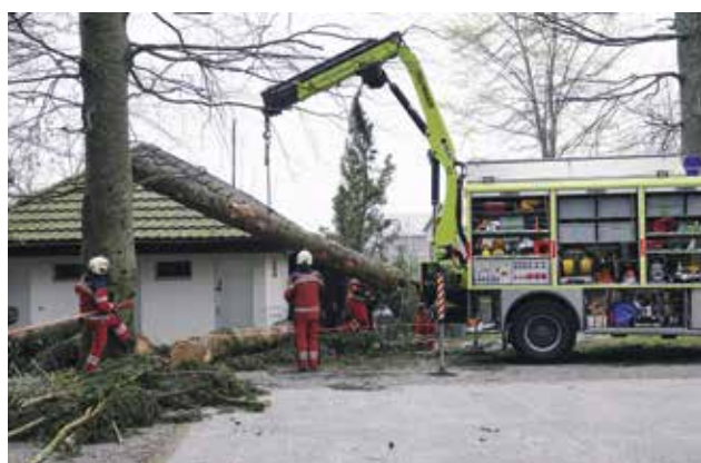
Der Eingang zum Bootshaus der Seeretter muss freigeräumt werden.
